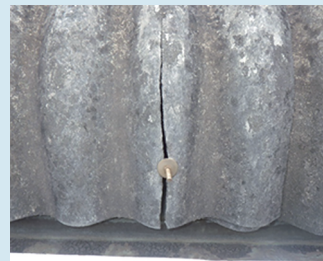
スレートの割れ
