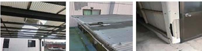
修繕個所の写真
