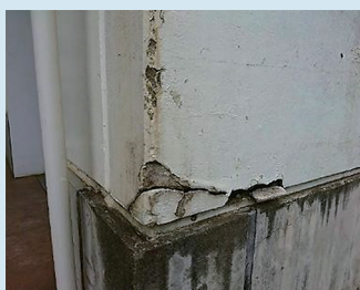
外壁のひび割れ
