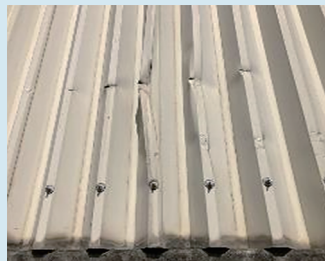
落下物による破損
