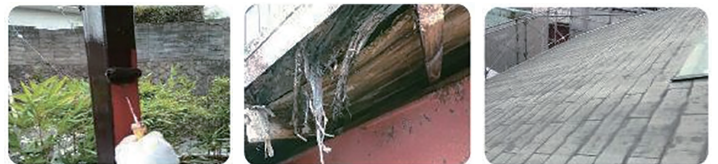
修繕個所の写真
